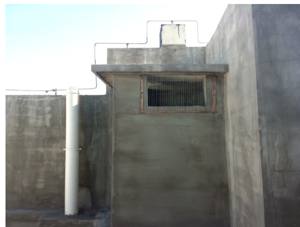
厨房油烟排放管道
