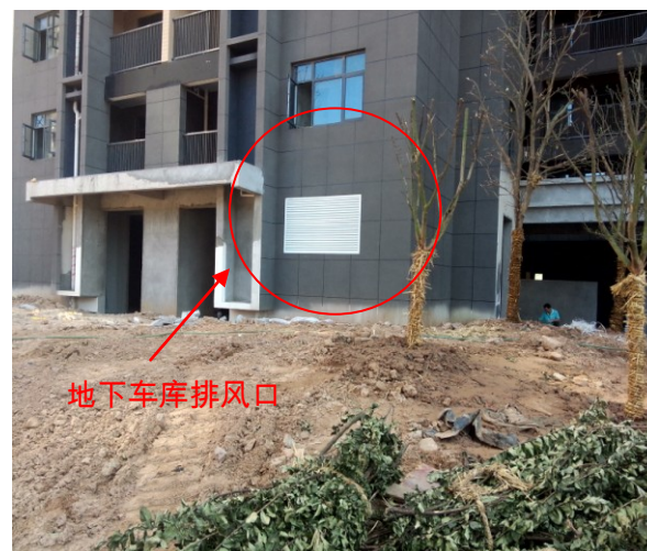
地下车库排风口
