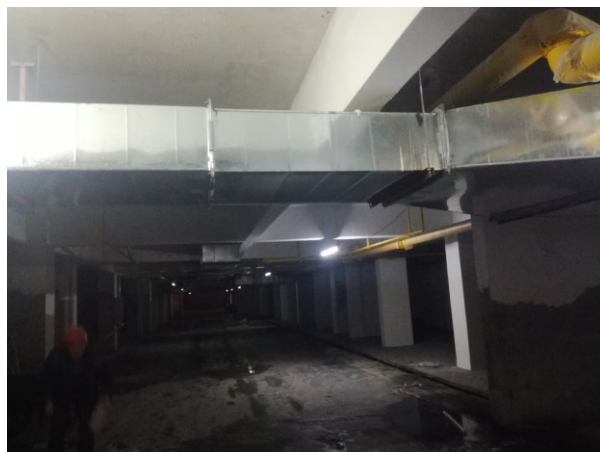
地下车库排气装置
