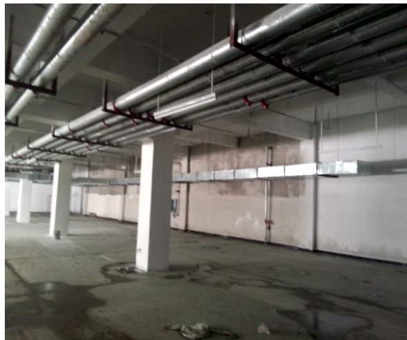
地下车库换气管道
