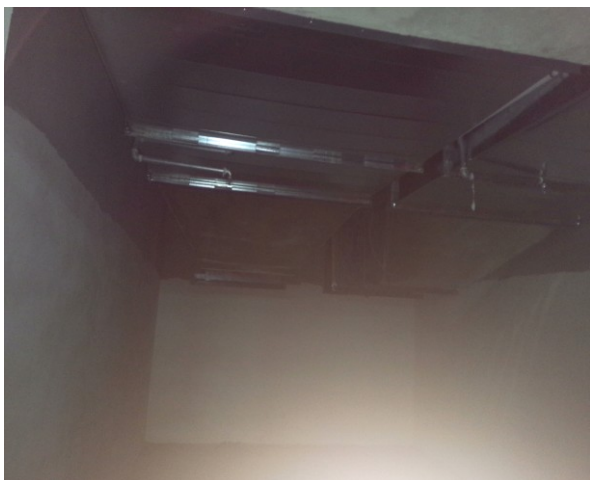
地下车库换气装置
